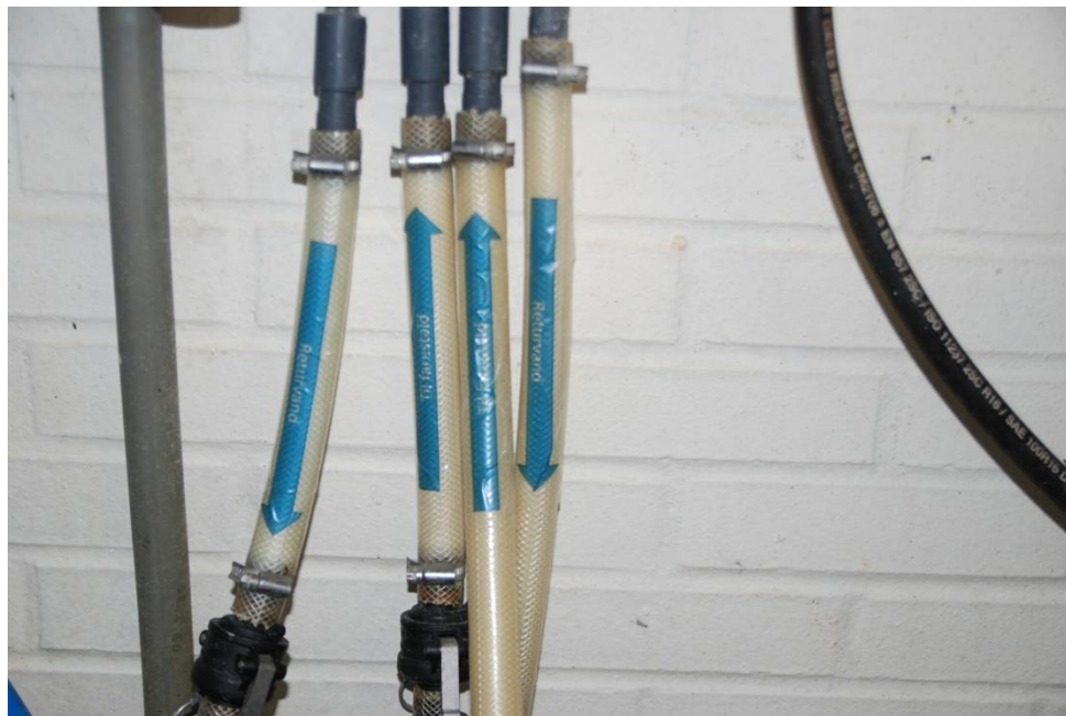
Nemt at se hvilket rør, der skal skiftes i forhold til pumpning mod stald og returnvand
